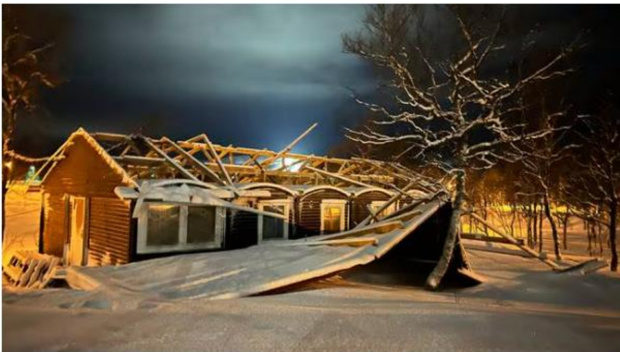
Ekstremværet «Ingunn» har ført til store skader på klubbhuset til Medkila skilag.
